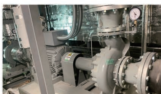
冷却水ポンプ
