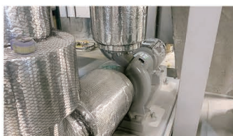
冷温水ポンプ
