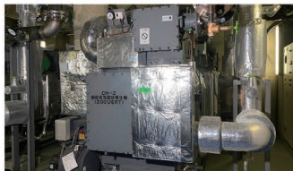
冷温水発生機
