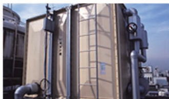
受水槽・高架水槽
